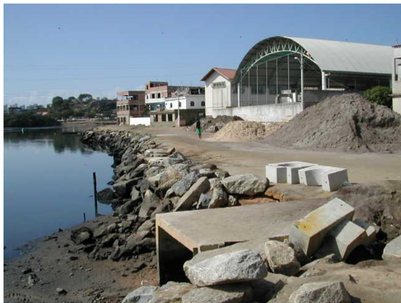
Figura 16. Galeria de esgoto sem tratamento, Vitória, ES (2003)
