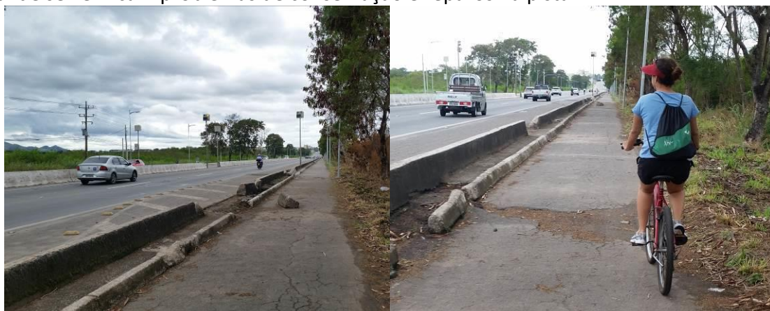
Figura 10 - Passeio Compartilhado da Av. Fernando Ferrari, próximo ao aeroporto, onde se verificam problemas de conservação e reparos na pista.
